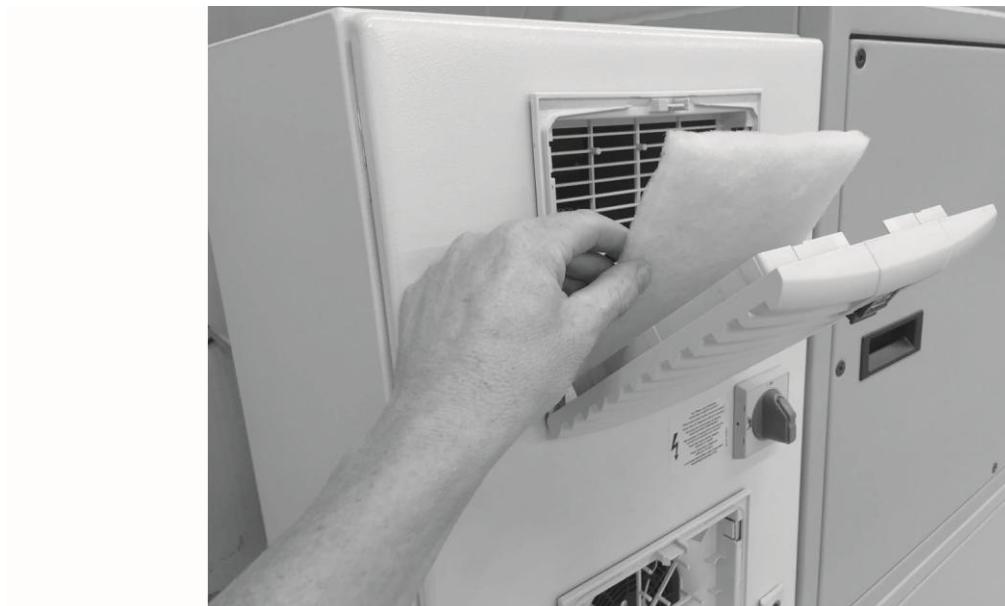
Obr. 39: Výměna filtrů skříňového rozvaděče
